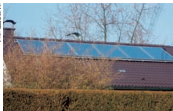
15 m 2 Kollektoranlage zur Brauchwassererwärmung und Heizungsunterstützung
