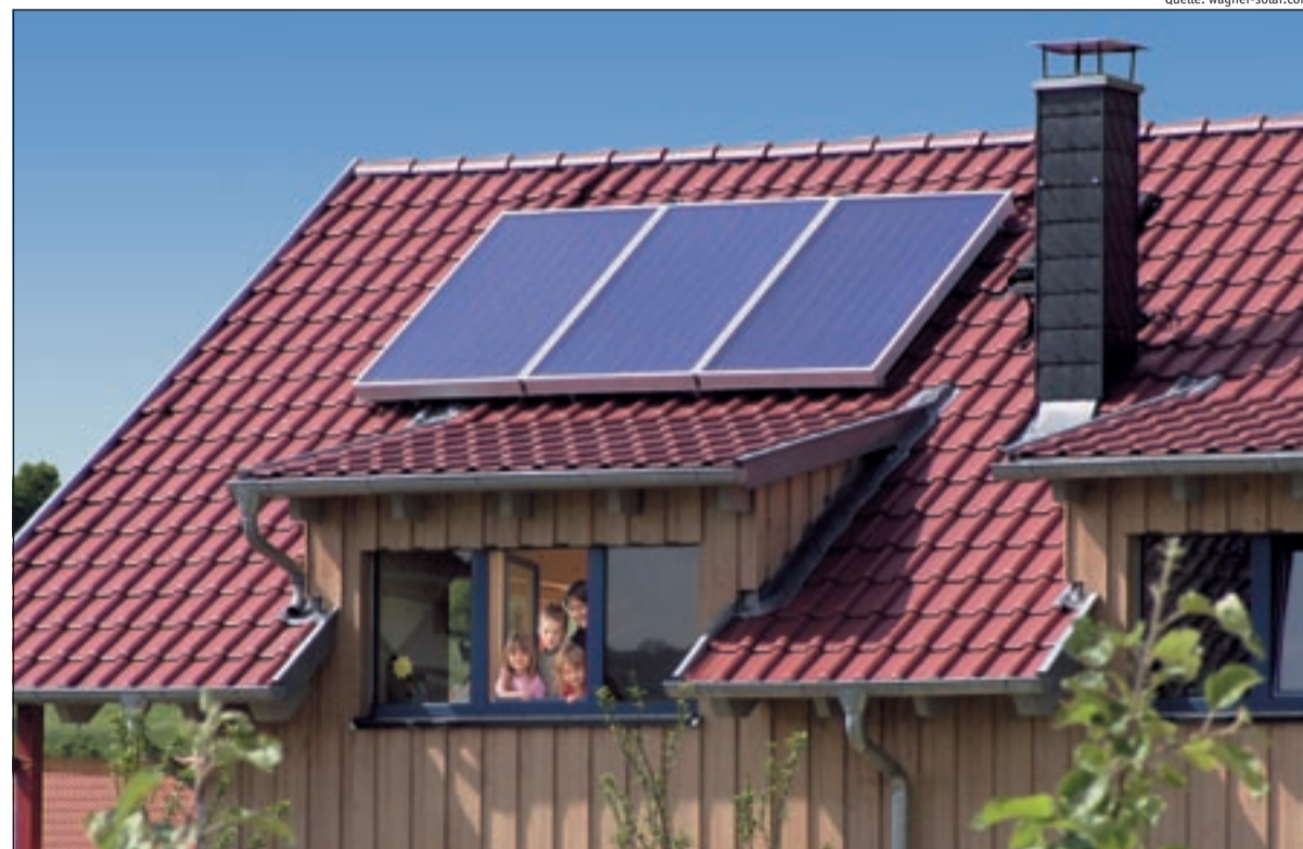
Sonnige Aussichten: Wer an die Zukunft denkt, hat eine Solarwärmanlage auf dem Dach. Sie reduziert die Abhängigkeit von Öl und Gas und schützt gegen weitere Energiepreissteigerungen. In einer modernen Heizung ist der Sonnenkollektor ein fester Bestandteil.
