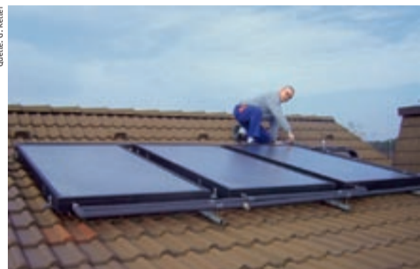
Kollektoranlage zur Brauchwassererwärmung
