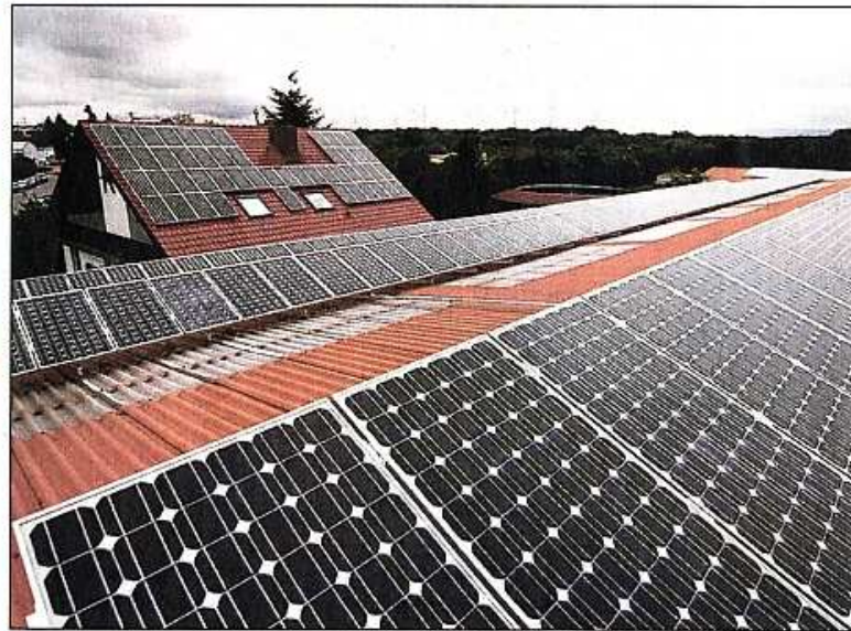
Solarmodule der Reitanlage bedecken eine Fläche von 1000 Quadratmetern. Bild: Schwerdt
